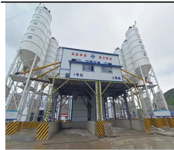
1号厂区混凝土拌合设备
