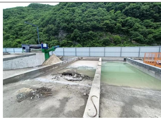
1号厂区三级沉淀池
